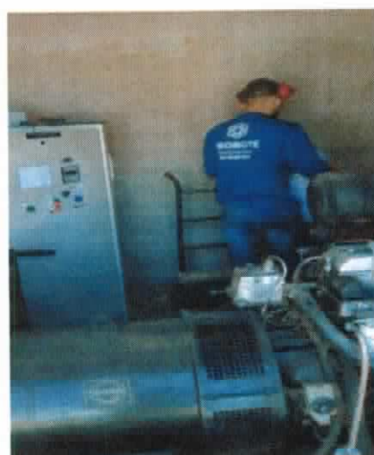
Figura 4. Manutenção Gerador - REOBOTE
