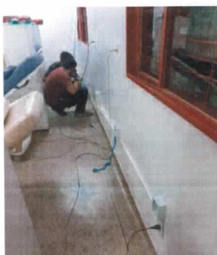
Figura 3. HR – Cabeamento de rede
